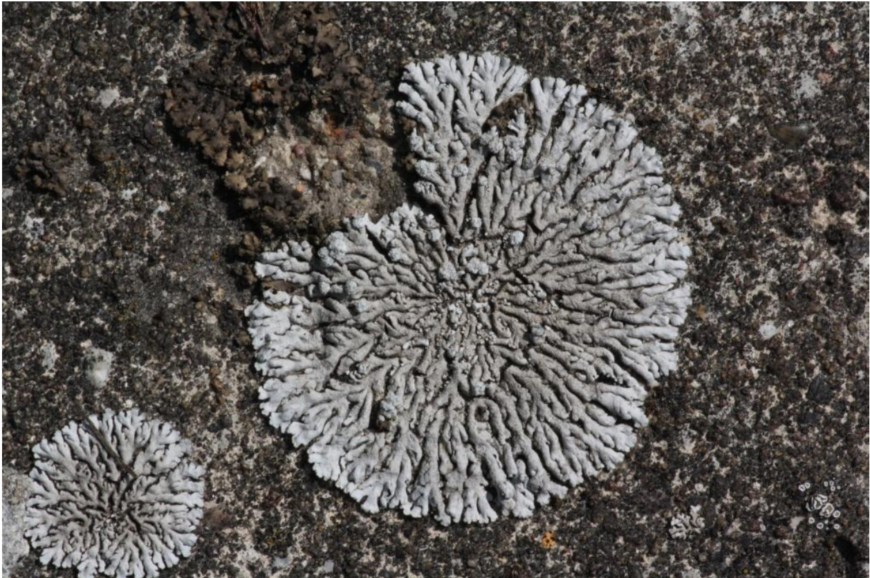
Fot. 1 Typowa, rozetkowata plecha obrostu modrego na betonie.
